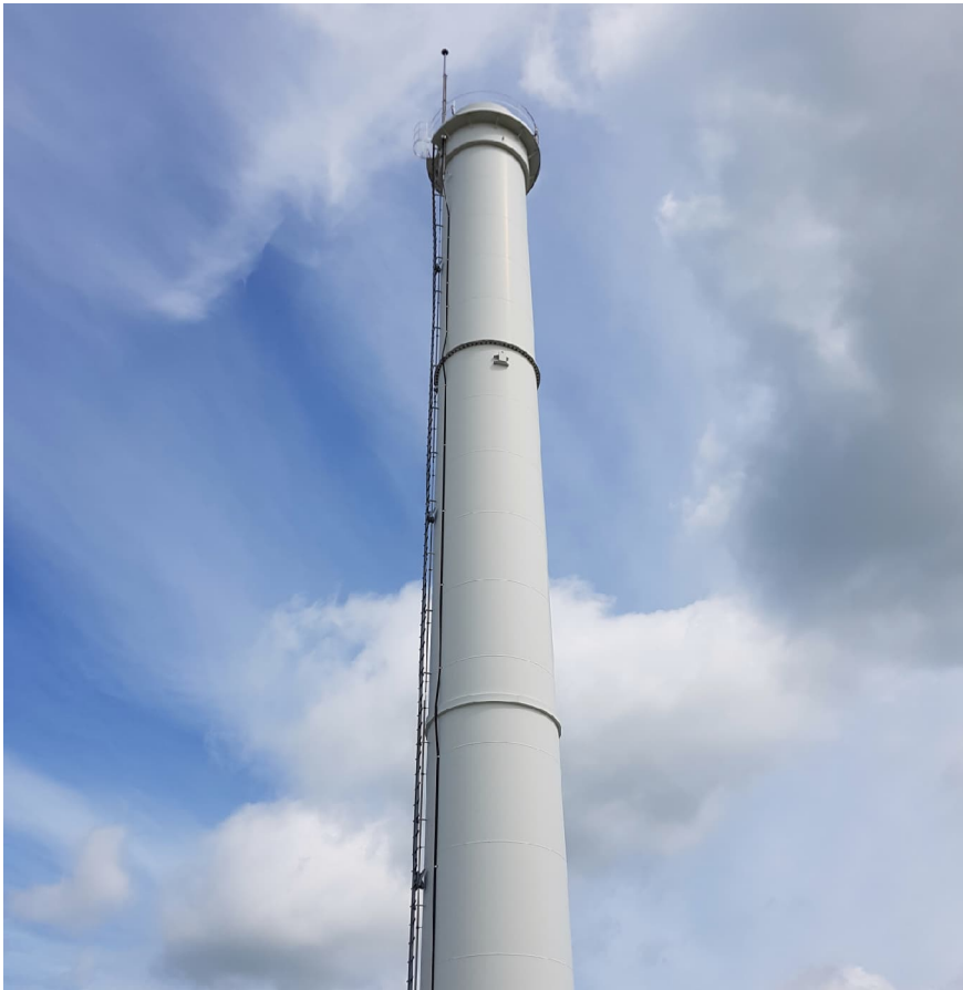
Figur 4-4 Skorsten på befintlig anläggning. Fotograferat juni 2022.
