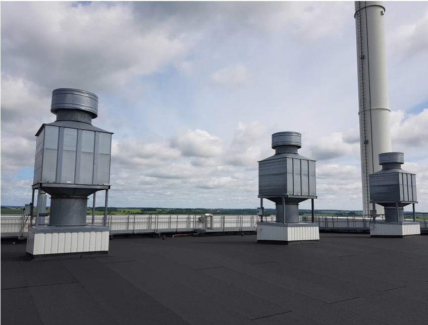
Figur 7-8 Exempel på en av bullerkällorna. Fläktar på taket vid befintlig anläggning. Fotograferat juni 2022.
